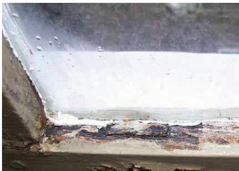
De condensatie aan de beglazing leidde tot aantasting van de kozijnen.
