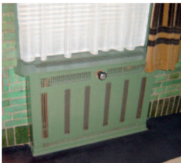
Figuur 3: Veel radiatoren in het Jachthuis zijn weggewerkt achter een op het interieur aansluitende omkasting.
